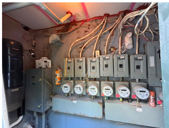
Salle électrique de la partie commune
